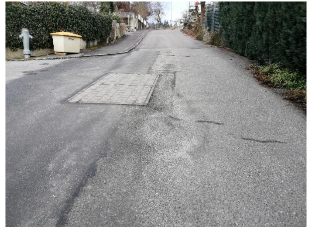
Starke Deformation der Strassenoberfläche
