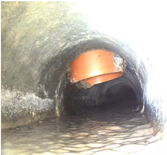
Verkalkte Sauberwasserleitung mit nicht fachmännisch ausgeführtem Anschluss
