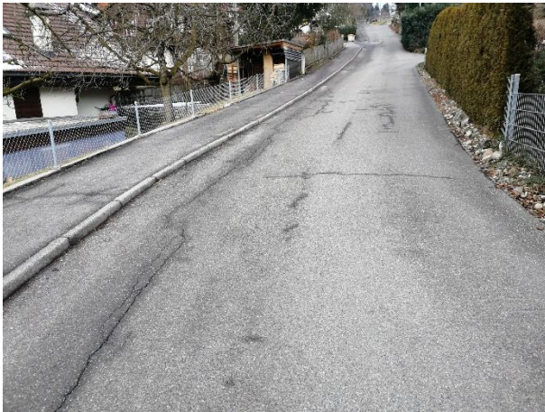
Risse und leichte Deformation der Strassenoberfläche
