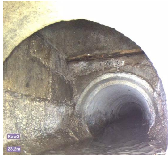
Schadhafter, überdeckter Kontrollschacht der Sauberwasserleitung
