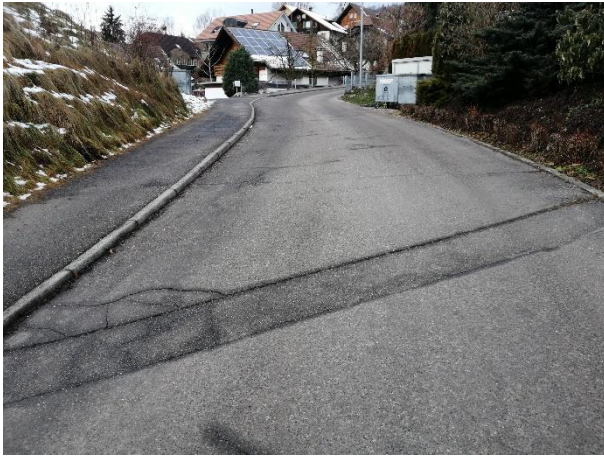
Risse im Bereich eines Werkleitungsgrabens
