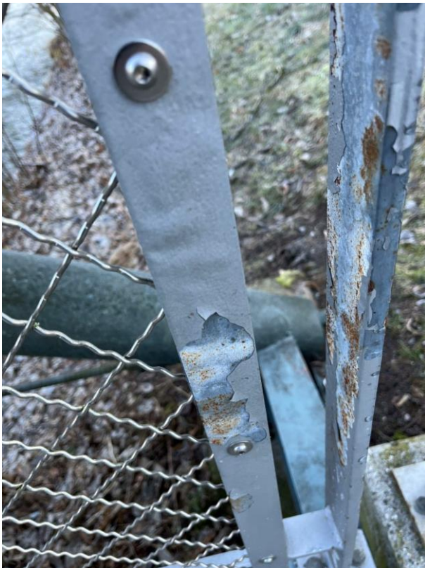
Farbschäden und Korrosion am Geländer
