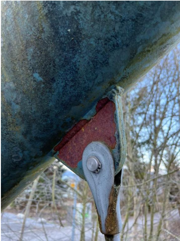
Farbschaden bei einem Knotenpunkt
