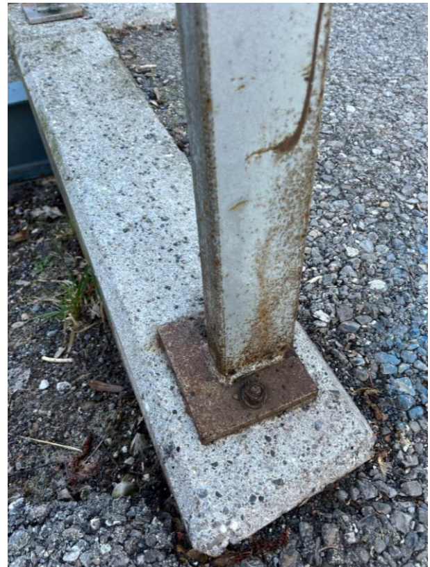
Korrosion am Geländerpfosten und Befestigungsanker
