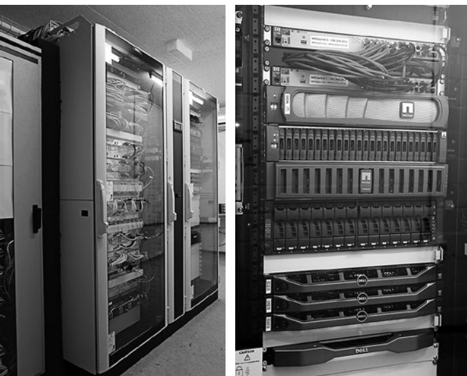
Neue Server mit integrierter Brandschutzanlage
