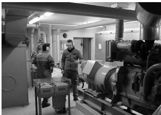
Anlagewartung in der Zivilschutzanlage Musterplatz
